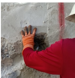
การซ่อมแซมผิวคอนกรีต ด้วยมอร์ตาร์กันซึมชนิดคริสตัลไลน์ PENECRETE MORTAR™
